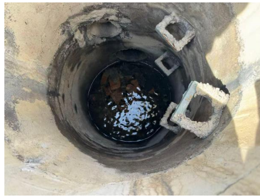
事故油池开盖
