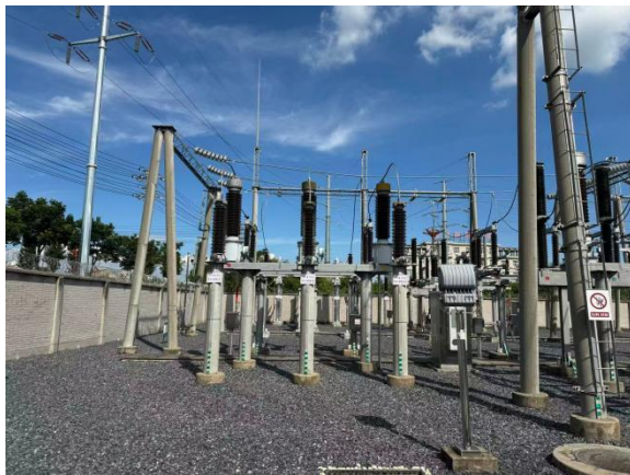
110kV 配电装置
