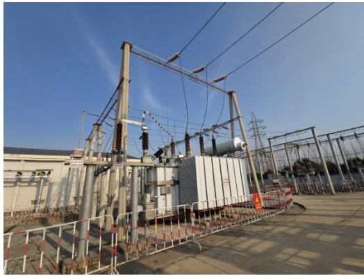
站内前期已建#1 主变（50MVA）
