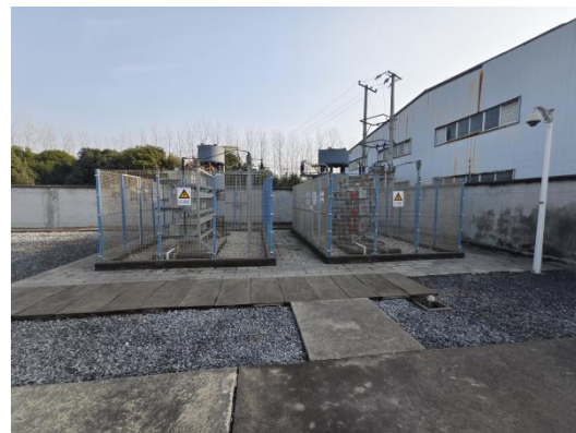
站内前期已建电容器
