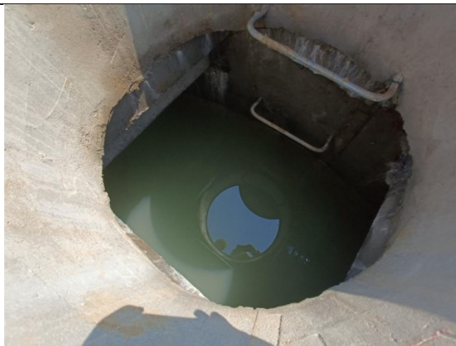
事故油池开盖
