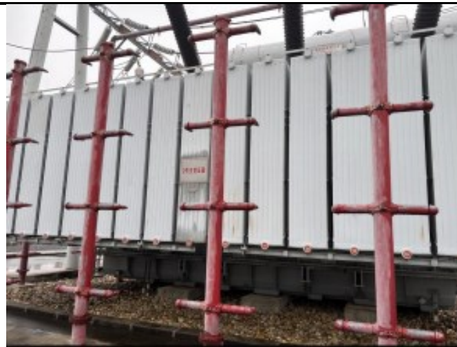
2#主变及事故油坑
