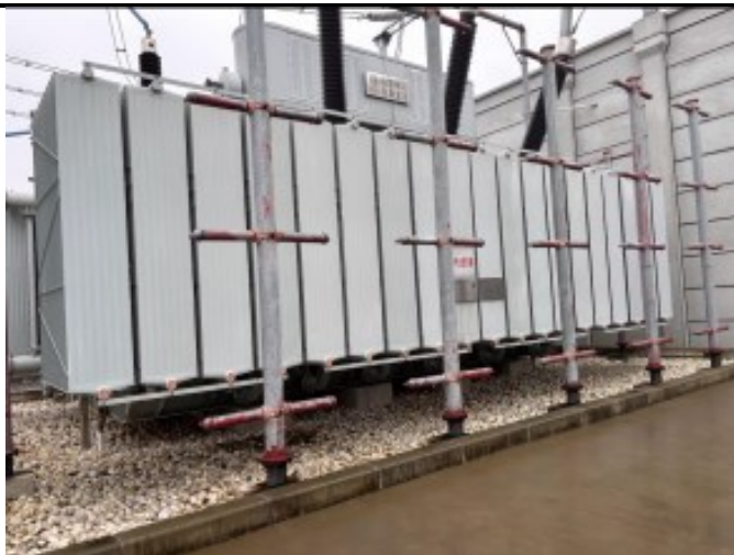
1#主变及事故油坑
