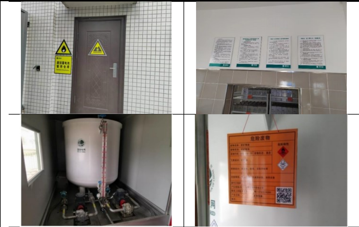
废矿物油暂存仓库
