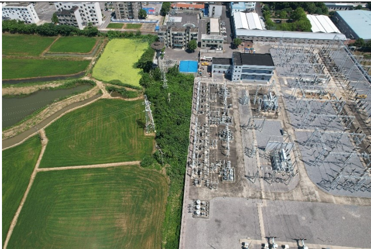
公安变西南侧厂界
