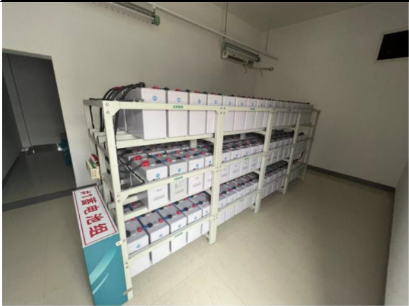
站内 220V#1 铅蓄电池组
