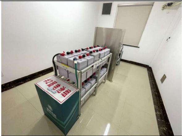
站内 48V#2 铅蓄电池组
