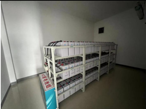
站内 220V#2 铅蓄电池组
