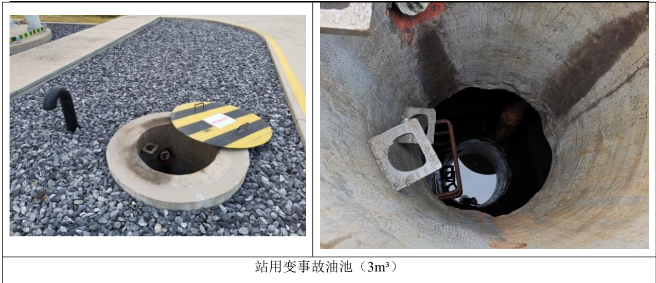
图 3-3 仙女山 500kV 变电站现状实景照片
