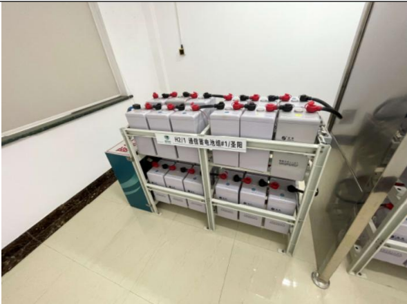
站内 48V#1 铅蓄电池组
