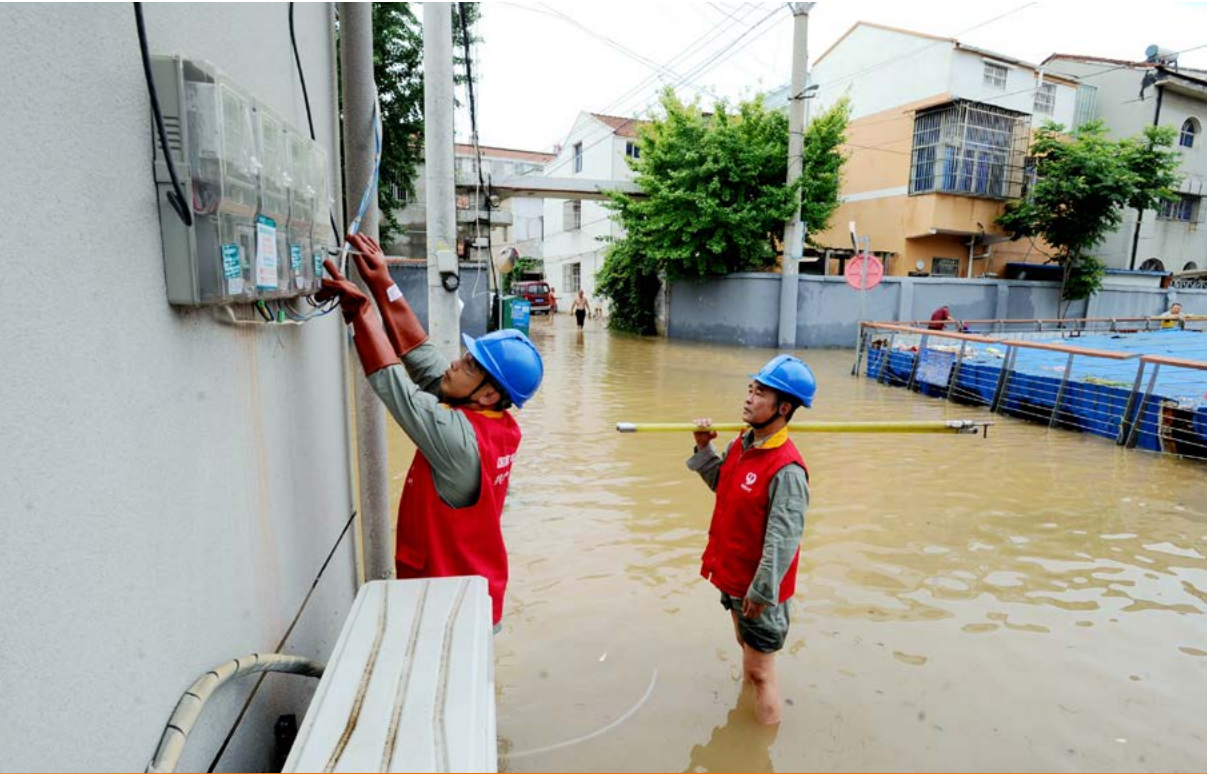
国网孝感供电公司抢抓雨停“窗口期”及时排查城区内涝小区用电情况
