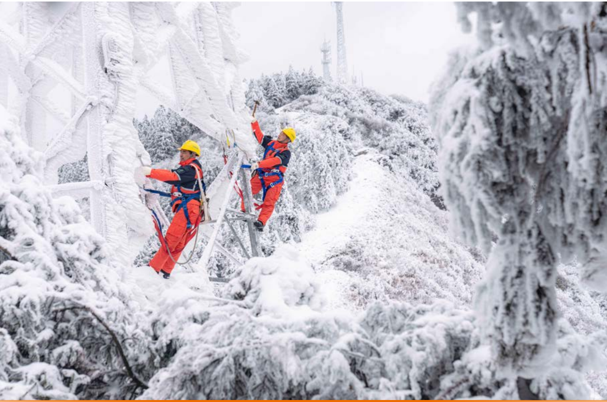
国网恩施供电公司及时组织保电人员对穿越高寒地带的线路开展特巡
