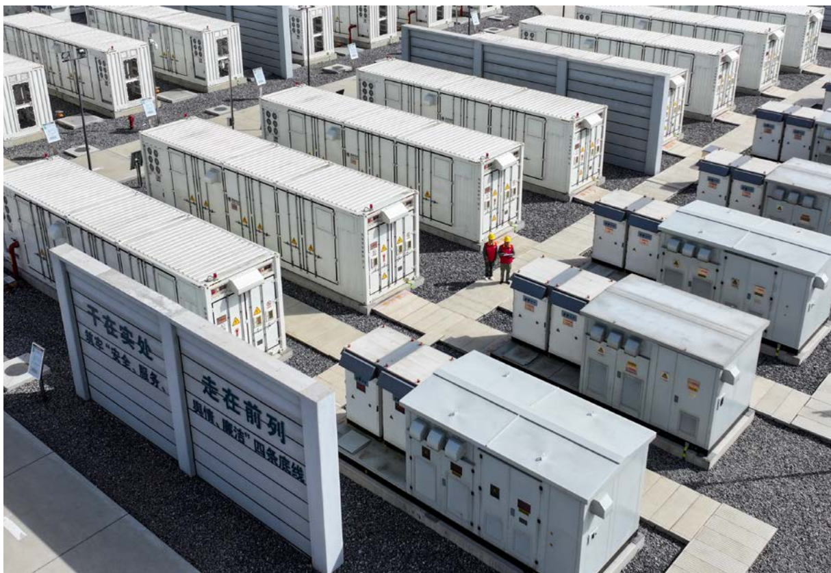
国网荆门供电公司变电运维人员对新港储能电站进行春检春查
