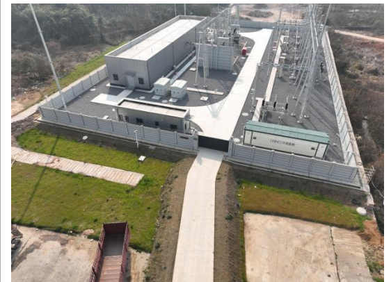
变电站航拍图
