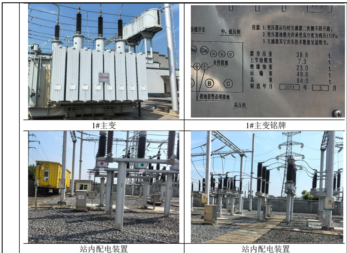
图 2-2 变电站内现有主变、配电装置情况图
