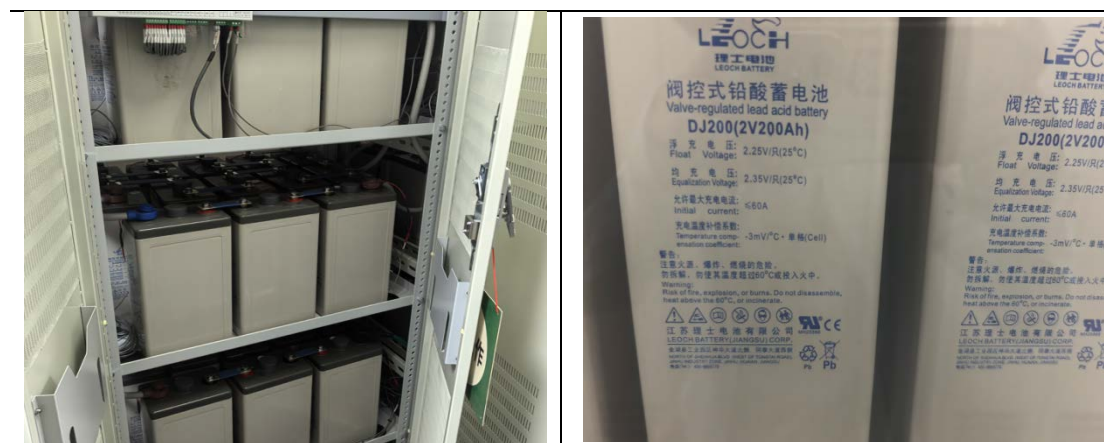
图 2-3 变电站内铅蓄电池照片
