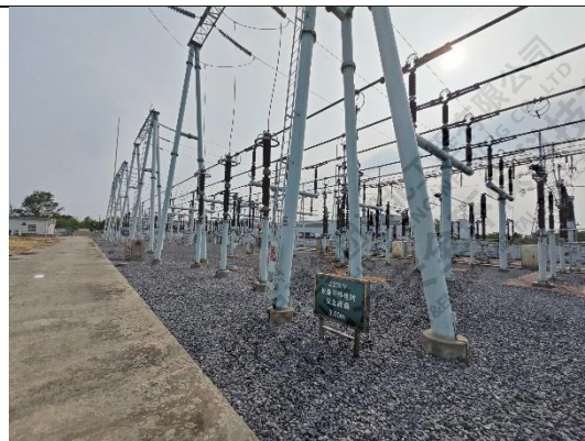
220kV 配电装置区
