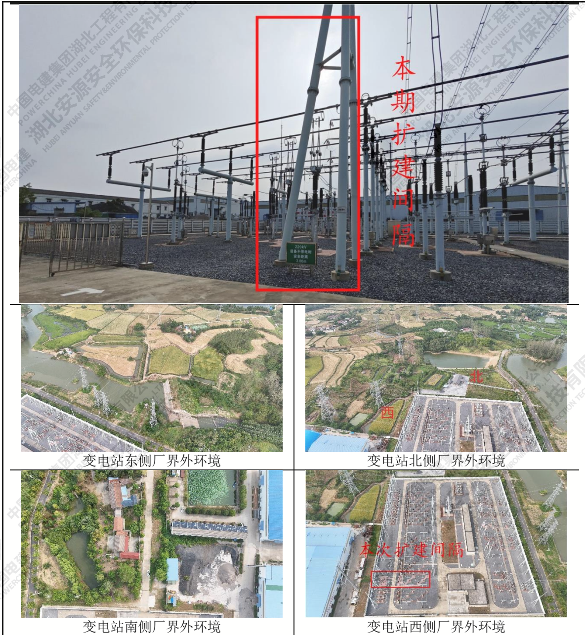
图 4-5 本期五里 220kV 变电站现状照片
