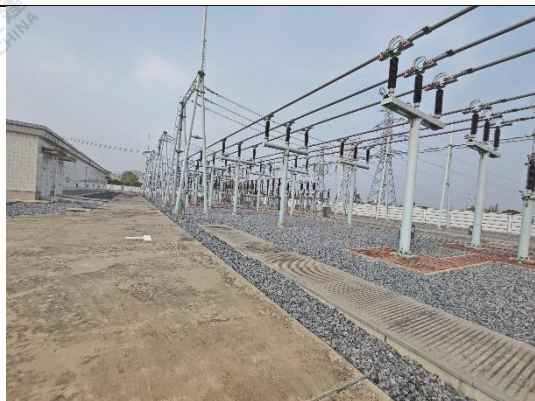
110kV 配电装置区
