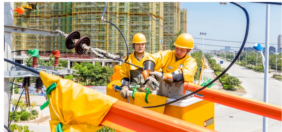
国网黄冈供电公司 员工奋战在抗高温 保供电前沿
