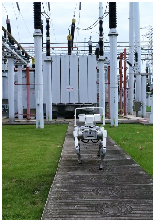
国网荆州供电公司使用“机器狗” 对户外设备进行智能巡视
