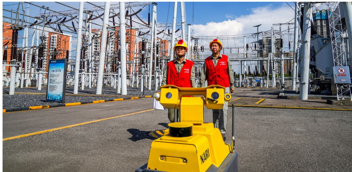
国网黄冈供电公司运维人员与巡视机器人协同智慧巡视
