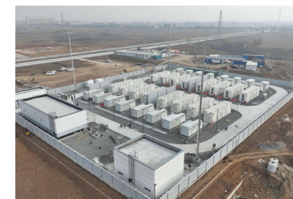
荆门新港 50 兆瓦 /100 兆瓦时构网型储能示范站（一期）
