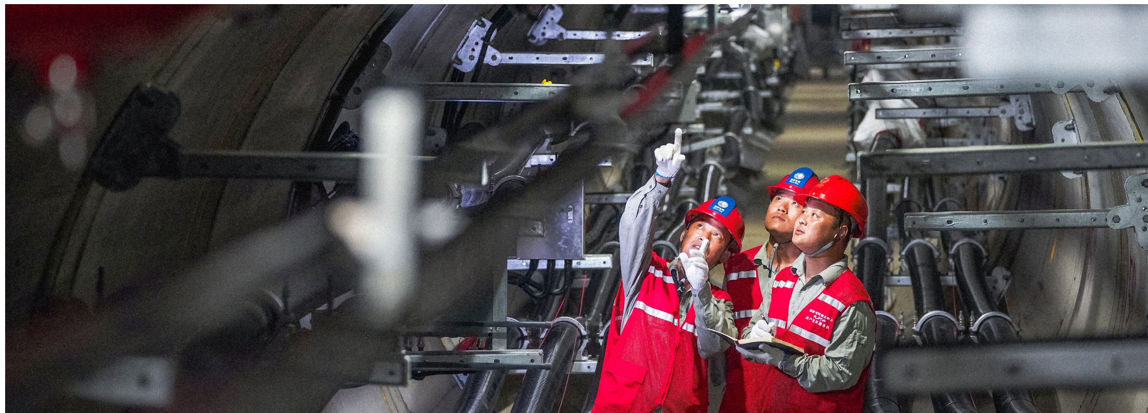
国网黄冈供电公司员工对管廊隧道内的 220 千伏电缆线路及设备进行检查验收
