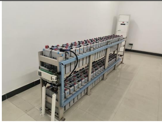
运行中的铅蓄电池组
