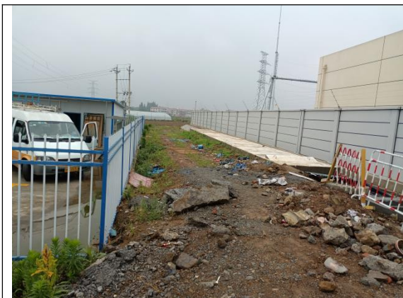
进站道路附近建筑垃圾未及时清理
