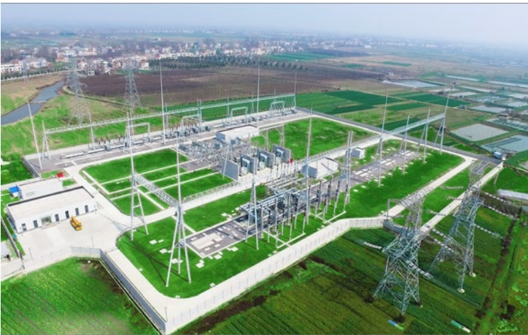
仙桃 500 千伏变电站工程
