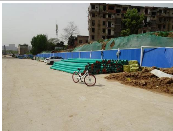
电缆沟区围挡板
