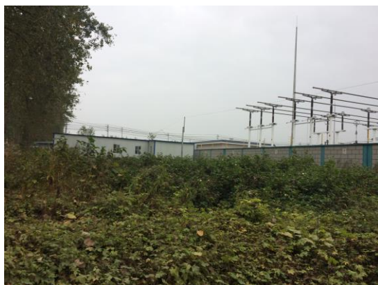
变电站西北侧外环境
