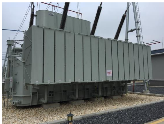
本期扩建2#主变压器
