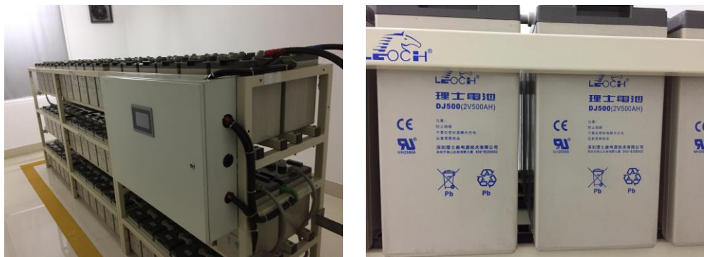
图8-3 站内铅酸蓄电池
