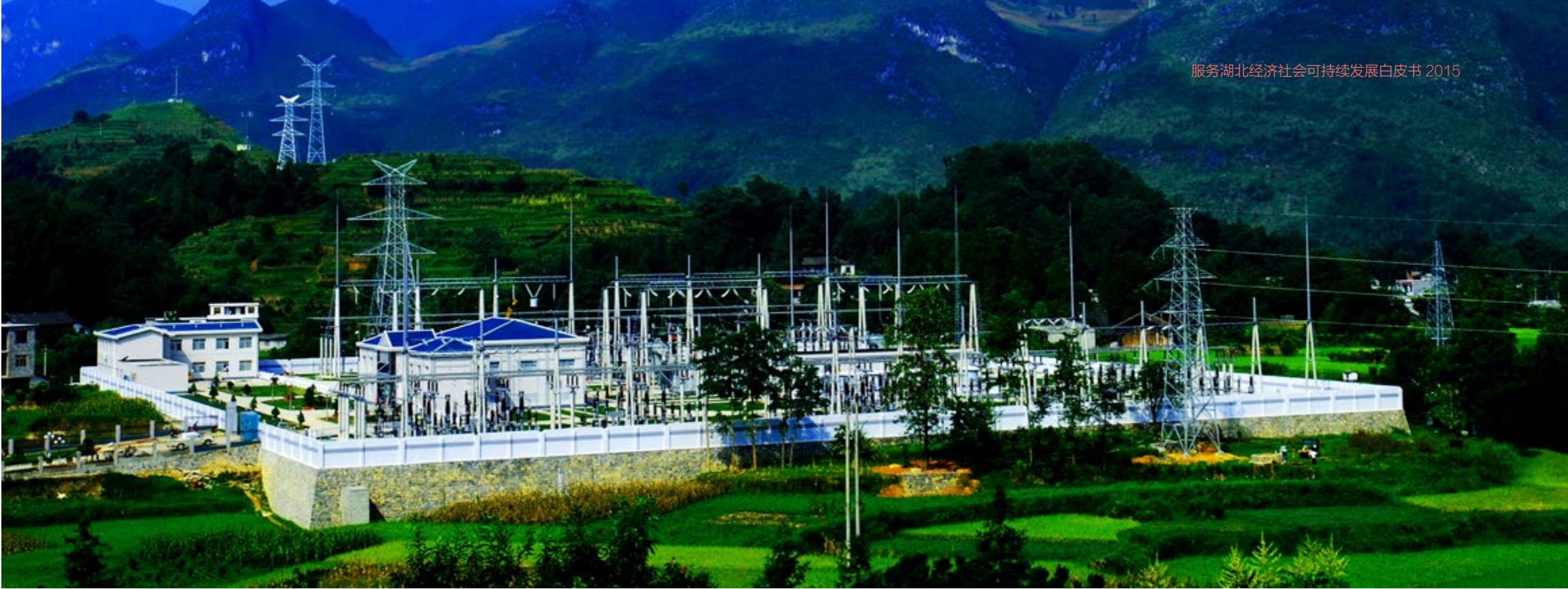
恩施州宣恩 220 千伏变电站
