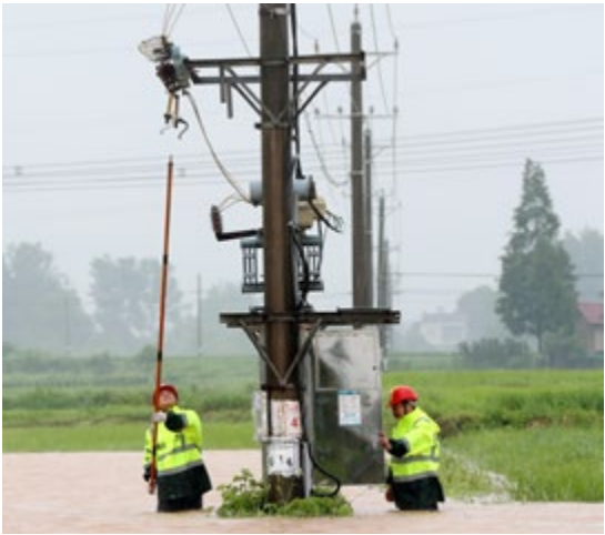
供电所员工涉过洪水，断开台区电源，保障电力安全
