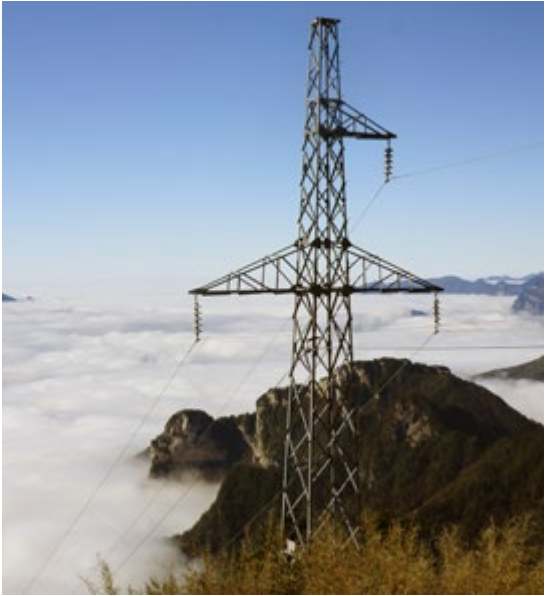
神农架 35 千伏线路杆塔
